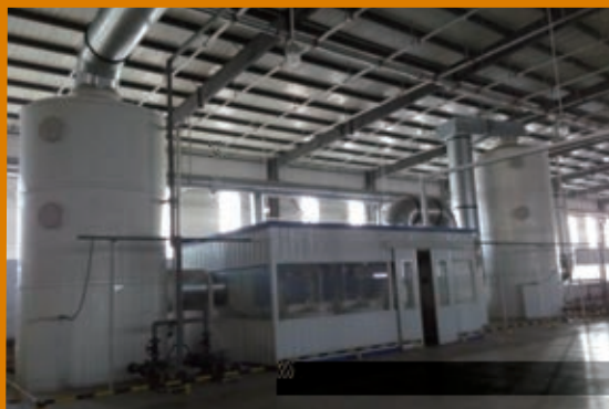
海綿發泡廢氣處理裝置1
