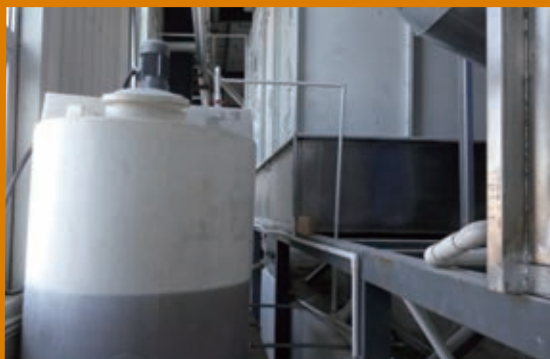
板式傢具廠廢水處理裝置
