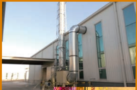
海綿發泡廢氣處理裝置2
