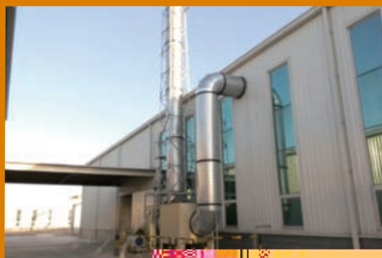
海綿發泡廢氣處理裝置2
