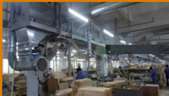
木工車間粉塵收集裝置
