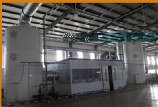
海綿發泡廢氣處理裝置1
