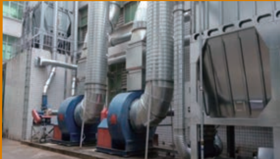
木工車間粉塵處理裝置
